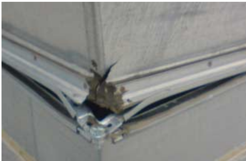
Detail poškodeného potrubia – nevyhnutná oprava
