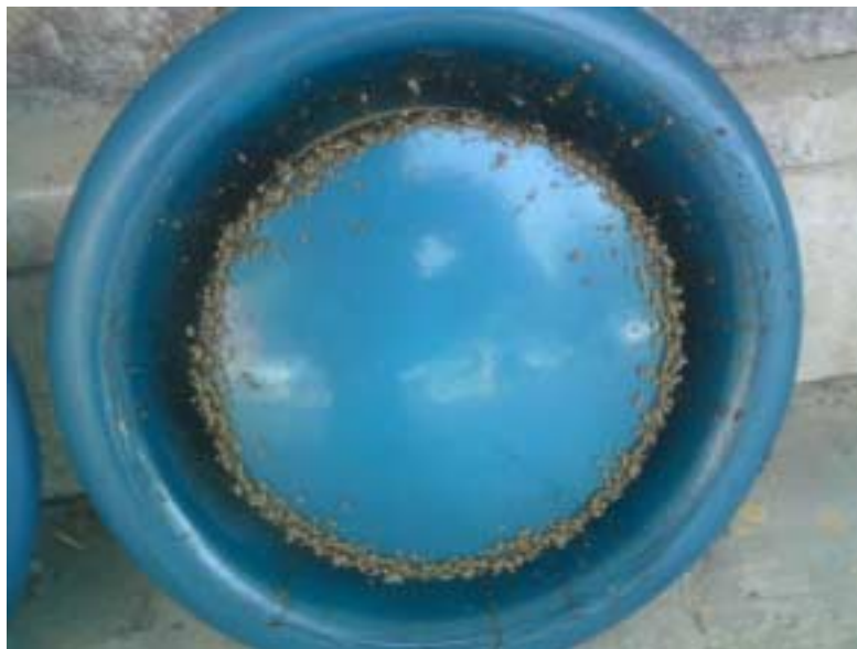
Príklad znečistenej výustky – výsledok zanedbaného servisu
